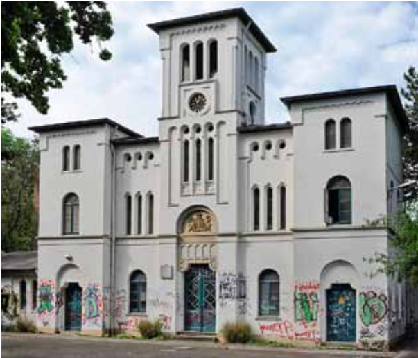
Die neugotische Fassade der Wasserkunst von 1864 wurde Opfer unschöner Graffiti-Schmierereien.
