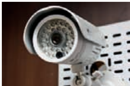
Videoüberwachungssysteme in Verbindung mit einer Alarmzentrale geben zusätzliche Sicherheit.
